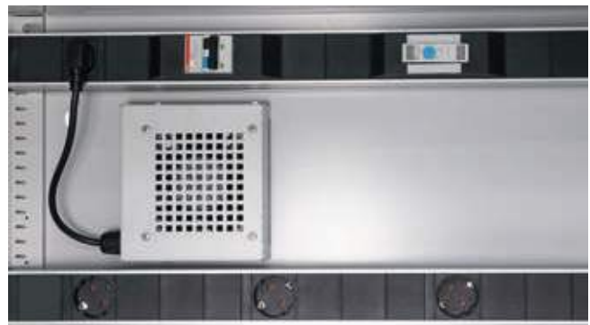
Temperaturgesteuerter Lüfter und Zentrale Masterleiste beim Comfort-Schrank
